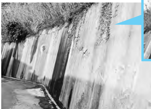
亀裂が進む兼城相互団地の擁壁
